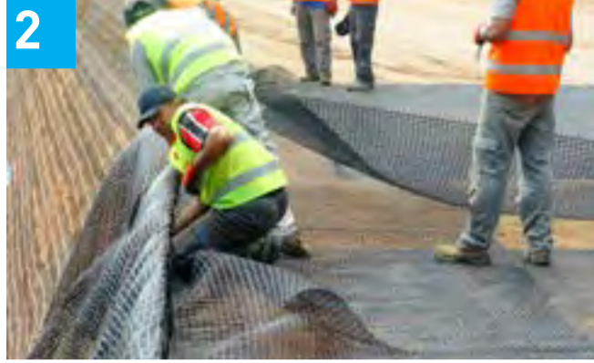
Dolgunun sıkıştırılmasının ardından yüzey elemanı çelik hasır ve bitki tutucuların hazırlanıp sahaya uygulanması
